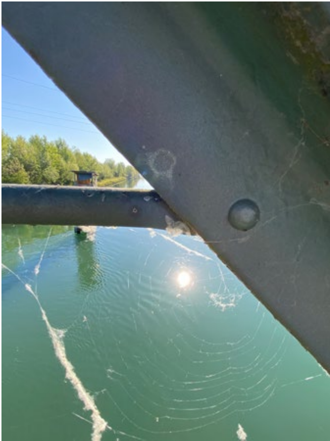
Die bestehende Stahlkonstruktion weist altersbedingte Gebrauchsspuren auf.
