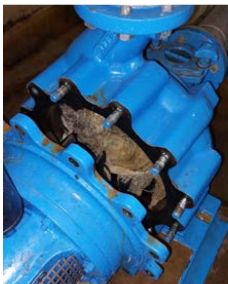
Durch Unrat blockierte Pumpe
