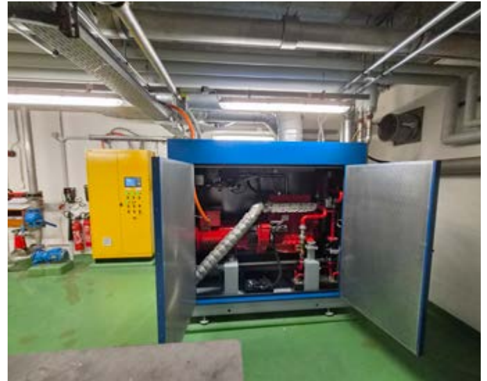
Das neue BHKW produziert aus Klärgas Strom und Wärme für den Eigenbedarf
