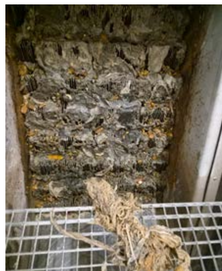
Anlage zum Müll abtrennen
